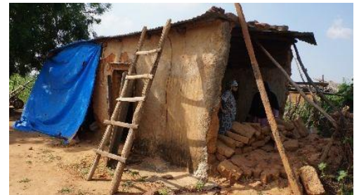
Stark beschädigtes Haus
